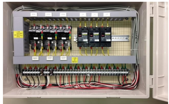
【停電時切替操作盤】
