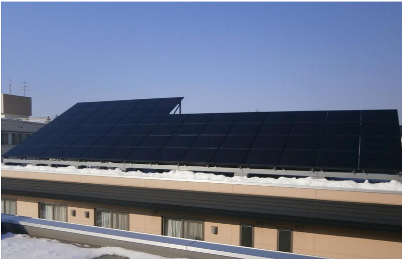
【発電モジュール】
